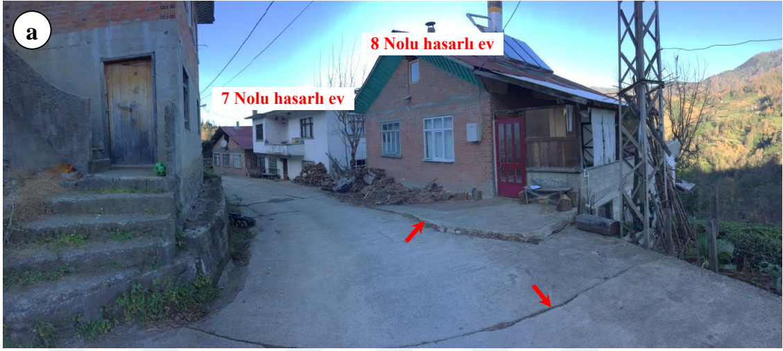
(a) Hasarlı 8 nolu ev ve (b) 4 nolu evin altındaki taş duvarda gelişen çatlak
