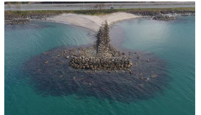
Şekil 4. Çalışma alanında görev yapan hasarlı T-mahmuz.
